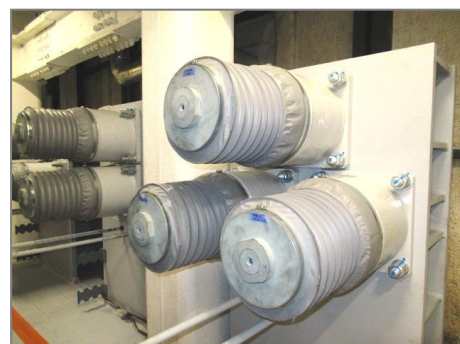
「オイルバッファ」設置写真
