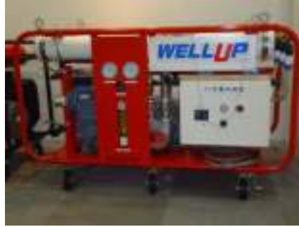
〔非常時飲料生成システム〕
