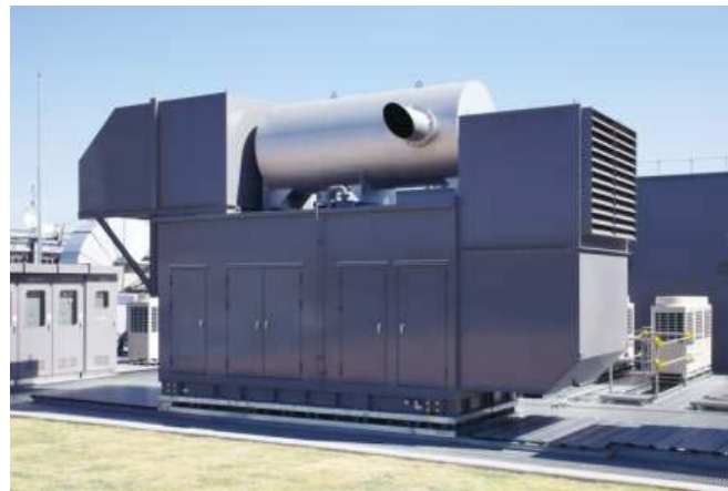
72時間の電力供給に対応する非常用発電機
