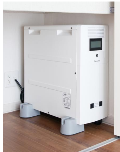
〔リチウム蓄電池〕
