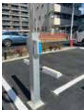
EV充電設備
