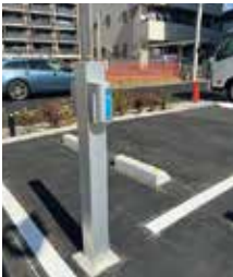
EV充電設備
